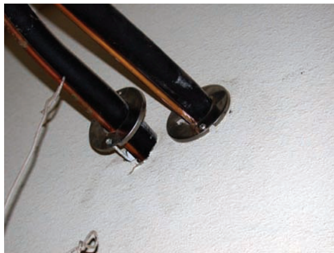
Loose escutcheon plates
